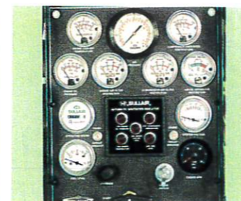
制御用表示パネル
